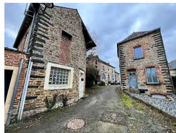
Nouveau percement inadapté
